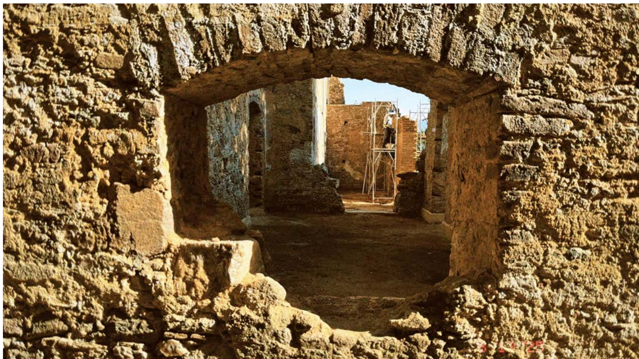
As intervenções de emergência visaram eliminar o risco de desabamento parcial ou total da estrutura
